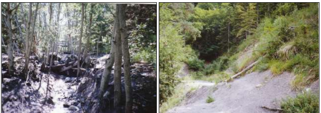
Figure 55 : Embâcle 100 m en aval de la RD (gauche) ; glissement de terrain coupant la route forestière de Naudet (droite)
