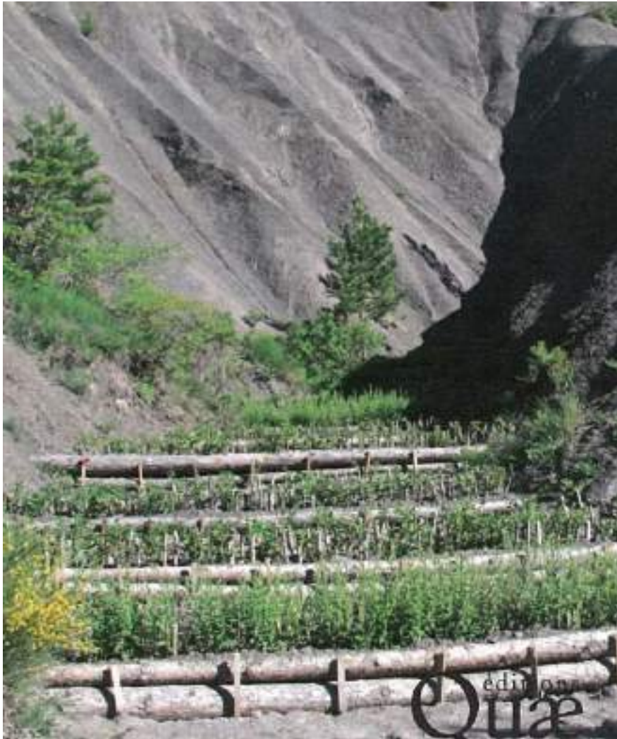
Figure 25 – Exemple d’aménagements permettant de limiter l’érosion en utilisant les billons issus de la coupe du bois (source : Génie biologique contre l’érosion torrentielle – Freddy Rey)
