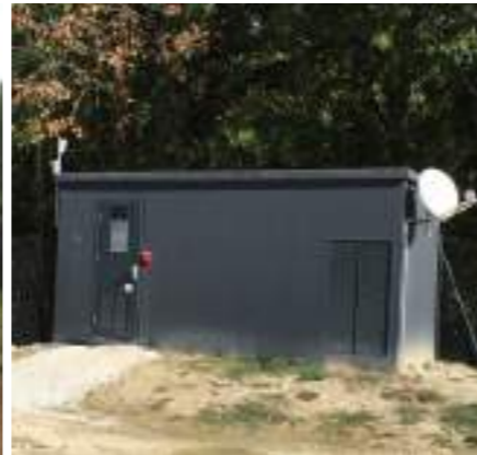
Poste de livraison
