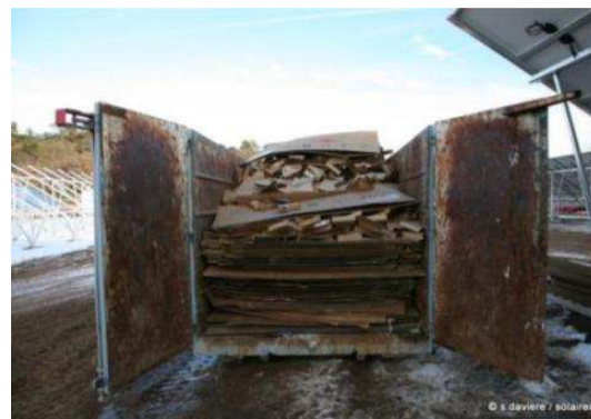
FIGURE 32 : TRI SELECTIF EXEMPLE SUR LE CHANTIER DE VINON-SUR-VERDON (EN BAS A DROITE)
