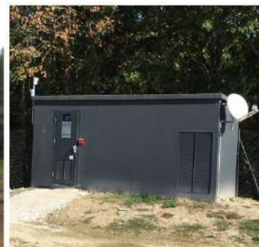
Poste de livraison
